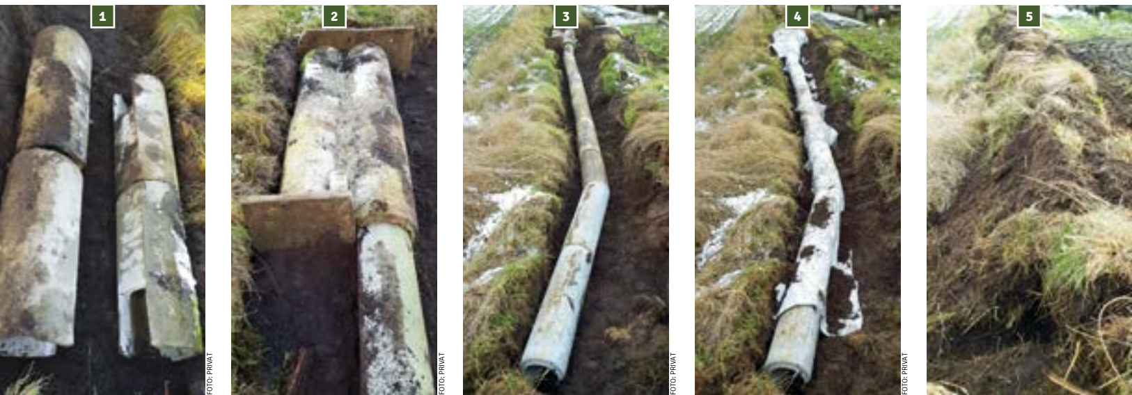
OBEN | Beim Demmel-Bau bilden vier Betonrohre den Kessel (Bild 1). Verschlossener Kessel (Bild 2). Die Rohre werden verlegt (Bild 3), alles mit Folie abgedeckt (Bild 4) und anschließend mit Erde bedeckt (Bild 5).
