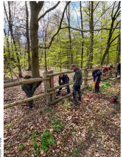
Der Zaun durch den Laubwald wurde kontrolliert und instand gesetzt, bevor die Wisente ins Sommergehege umziehen konnten.
